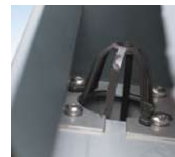
Gouttières équipées de crépines pour un bon écoulement des eaux pluviales
